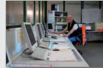
Leitwarte, Steuerung der Anlage
